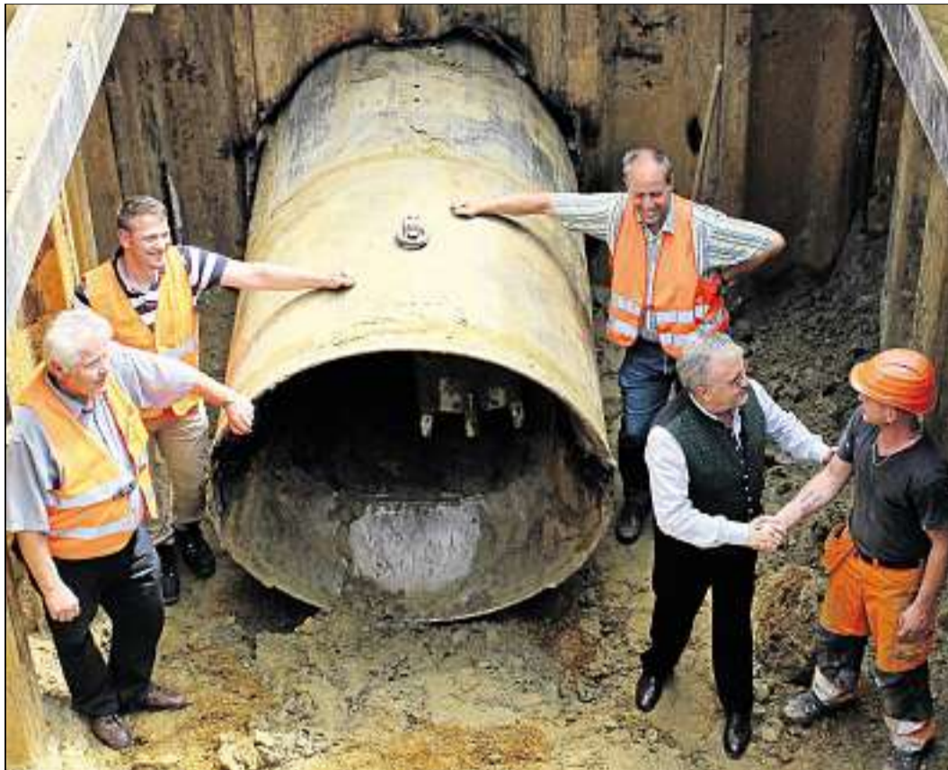
Gratulation zum Durchbruch: Hans Baierl (Zweiter von rechts) beglückwünscht Baggerfahrer Christian Damberger für seine hervorragende Arbeit. Auch Ingolf Schinkel (von links), der die Arbeiten im Auftrag der Deutschen Bahn begleitete, sowie Niklas Zimmer und Heinz Hoferer vom Ingenieurbüro WipflerPlan zeigten sich mit dem Bau des Regenwasserkanals in Bruckbach zufrieden.
